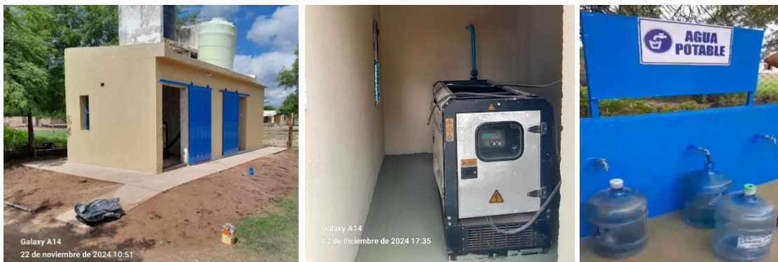
Instalaciones de Planta de Osmosis Inversa en Tacioj, Dpto Copo
